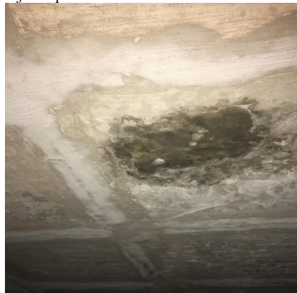
Figura 4: Infiltrações na parte inferior da laje da piscina
